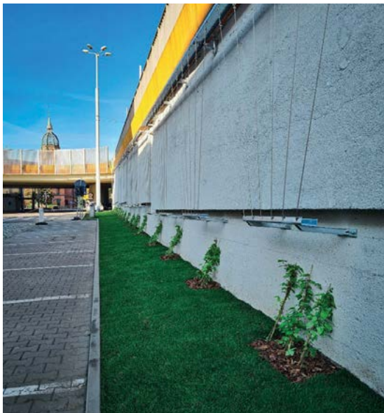
Fot. 4. Estakada przy ul. Moniuszki
